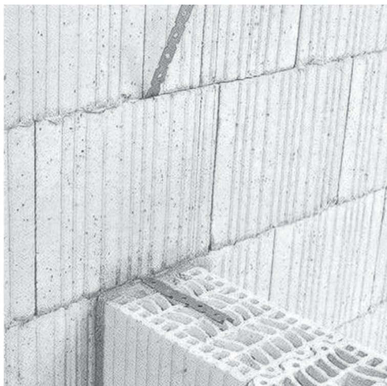
Рисунок В.11 – Пример сопряжения несущих стен с перегородками без перевязки с использованием полосовых анкеров
